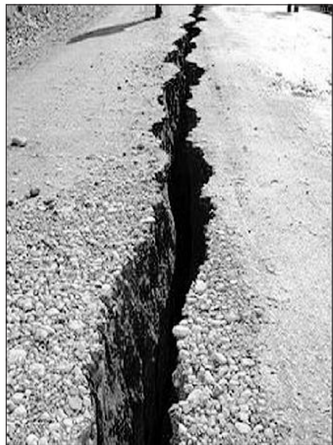
Un'immagine degli effetti del terremoto a L'Aquila
